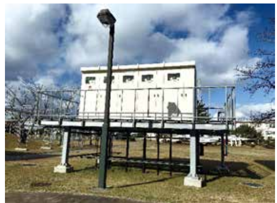
高所化した配電設備
